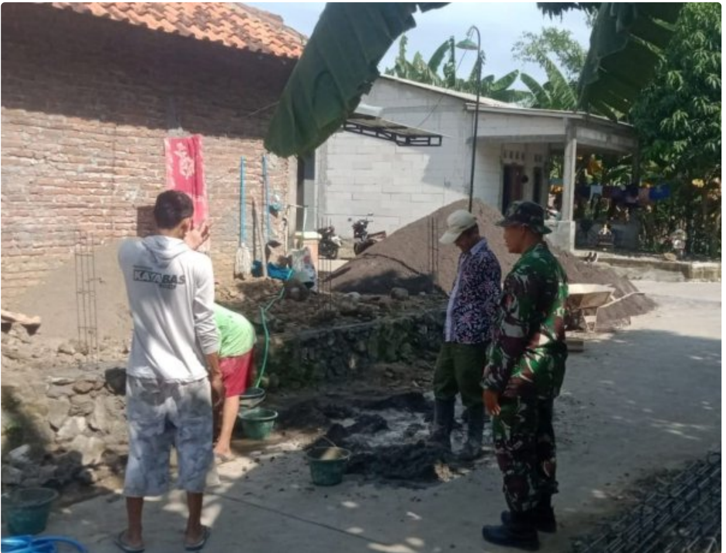
Koptu Sumijan melaksanakan karya bakti membantu warga membangun Pondasi rumah warga di Dukuh Ngaluran
